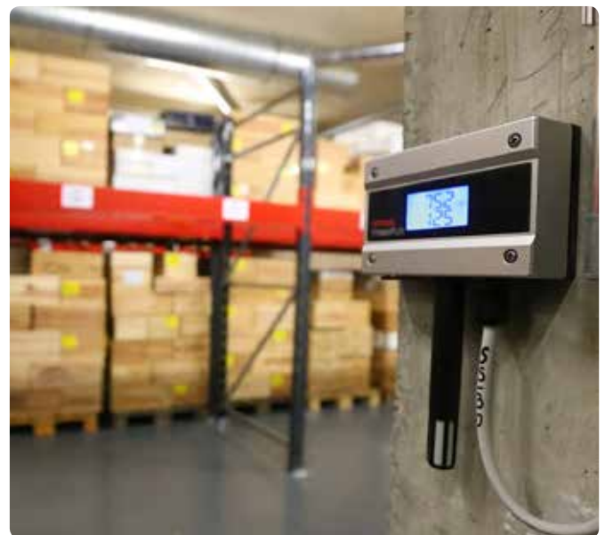
Monitoring eines Zollfreilagers
