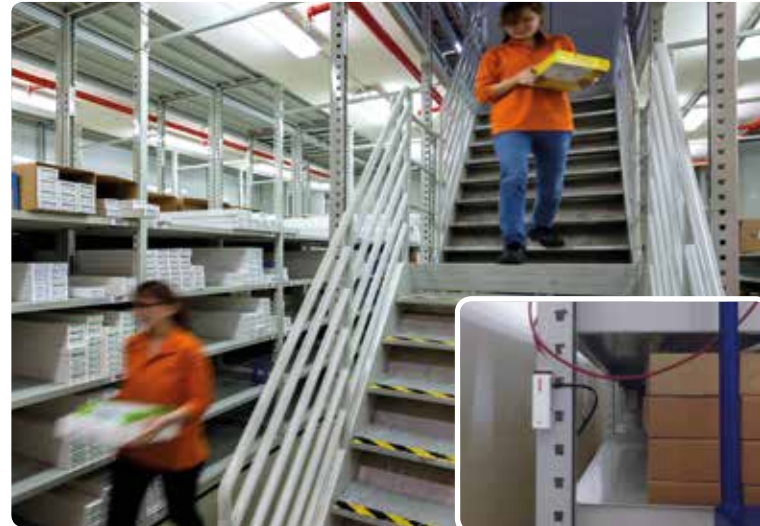
Im Lager installierte RMS Mini-Logger.
