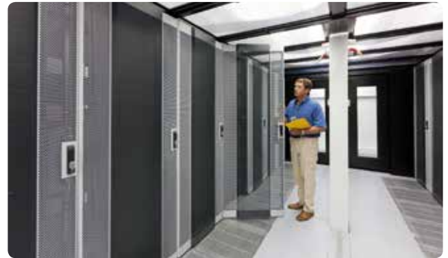
La méthode adiabatique indirecte assure un refroidissement très efficace du rack de serveurs.
